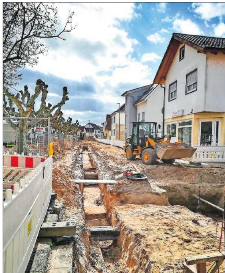
Aktuell laufen in der Speyerer Straße die Arbeiten an Gas- und Wasserleitungen.
